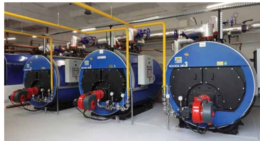
Fot. Nowoczesne kotły gazowe w CIEPŁOWNI na Osiedlu Zielonym.
